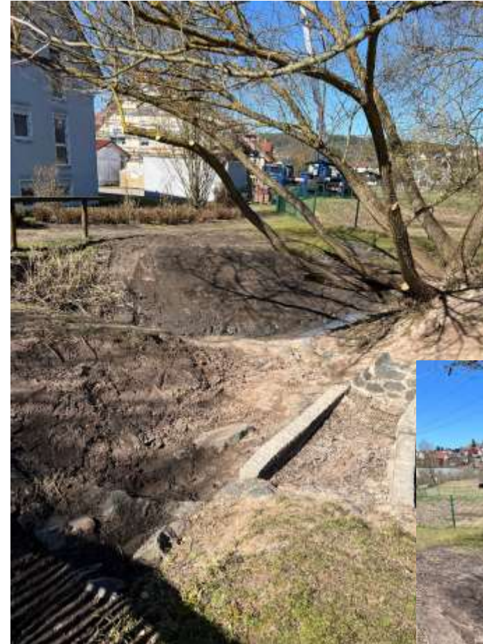
Entwässerung Einberg Ost
